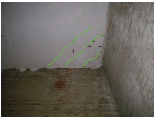
Rissbildungen Betondecke Ecke NW
