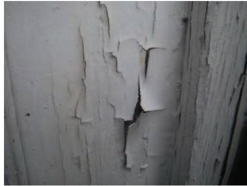
Detail abplatzende Beschichtung am Rahmen
