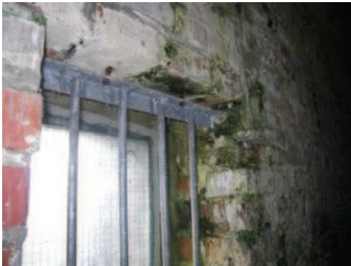
Innenansicht mit Algenbewuchs
