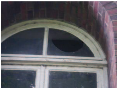
Ansicht gebrochene Scheibe im Oberlicht
