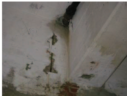
Detail Auflagerbereich mit undichtem Rohr
