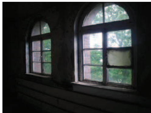
Ansicht Fenster mit festgerosteten Flügeln
