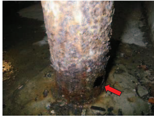
Detail Loch im Rohr
