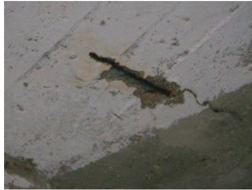
Detail aufrostender Bewehrungsstahl
