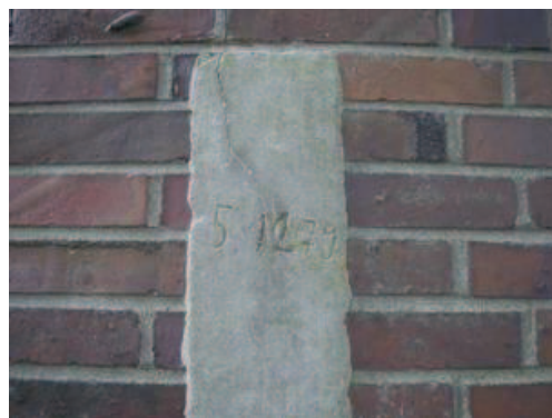
Alte Rissmarke an der Fassade West
