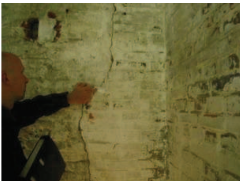
Rissbildung auf der Innenseite der Wand Ost
