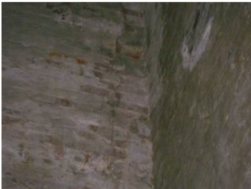
Rissbildung Ecke Nordwest, 5. OG
