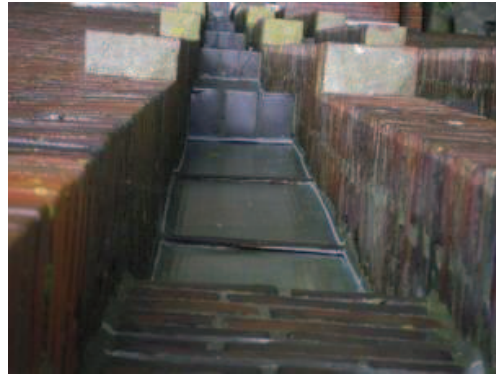
Ansicht mangelhafte Fensteranschlüsse
