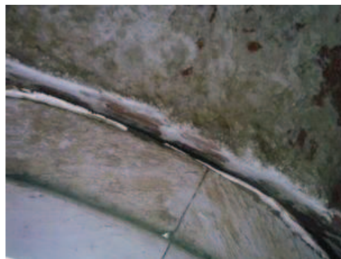
Detail fehlender Anschluss
