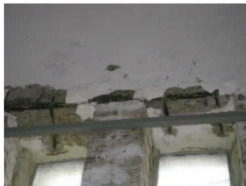
Detail freiliegende Bewehrung im Sturzbereich
