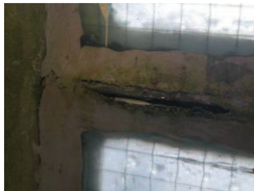
Detail undichte Verkittung von innen
