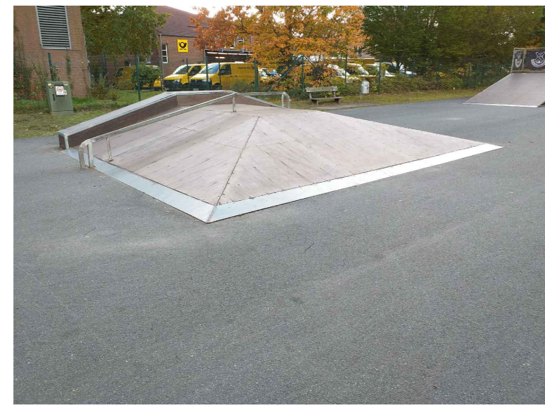
Asphaltfläche nicht mehr dauerhaft rollsportgeeignet, Belagsunebenheiten vorhanden, trocknet nur langsam ab
